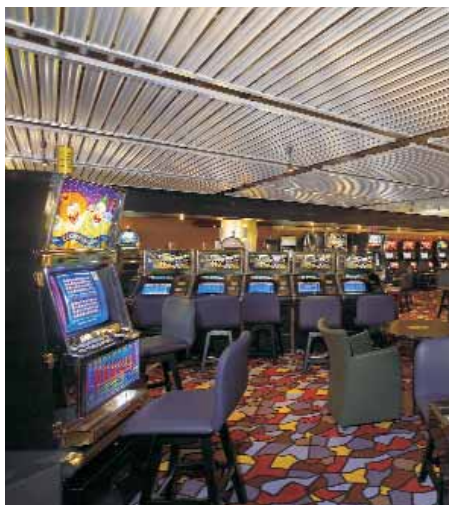
Holland Casino, Nijmegen / NL Koelplafondsysteem, Type SKS-5/1
