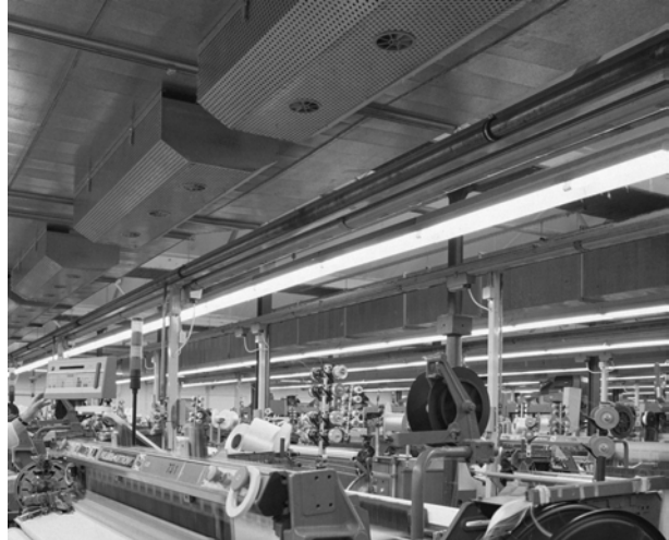
Bild 5: Trapezförmige Verdrängungsauslässe am Zuluftkanal einer Weberei
