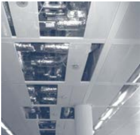
Einbausituation in einer Bank, Frankfurt
